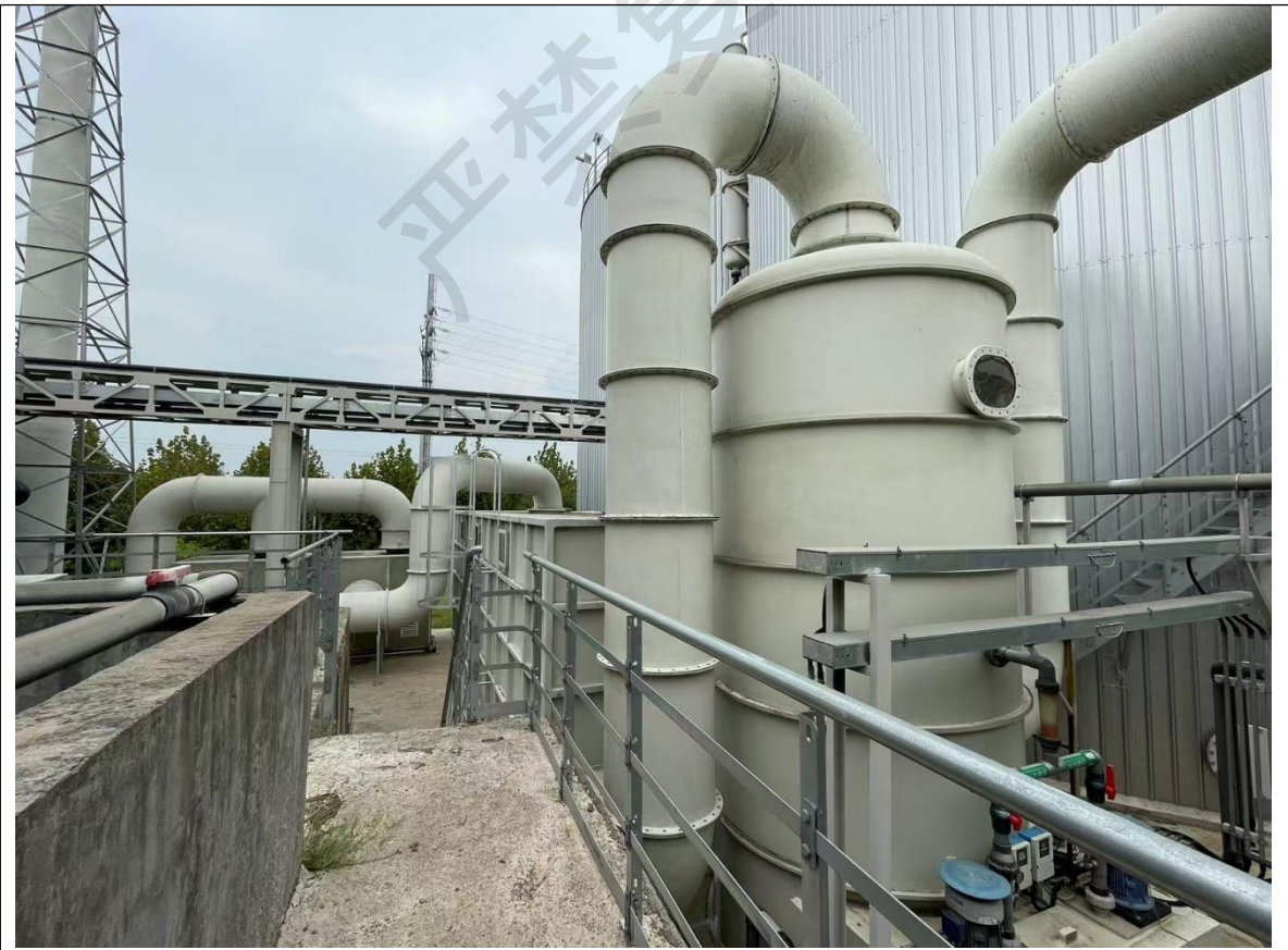
污水站废气处理设施
