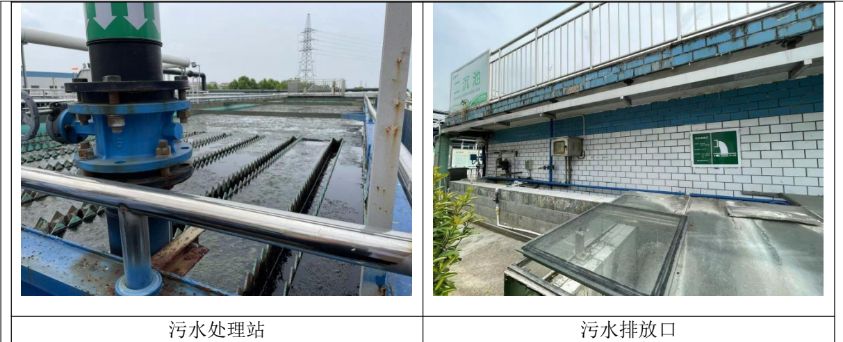
图 3-4 污水处理站现场图
