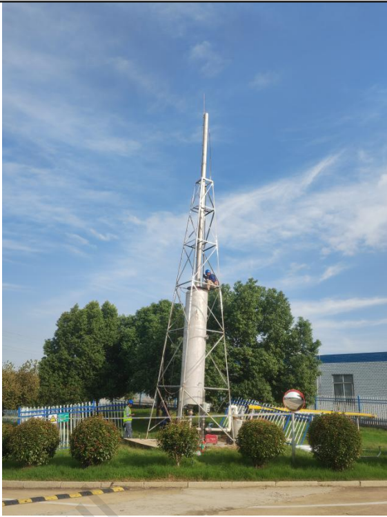
火炬燃烧废气排放口
