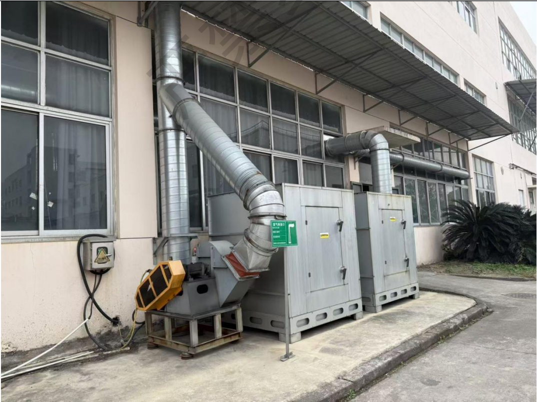
图 3-2 浸漆废气处理设施现场图
