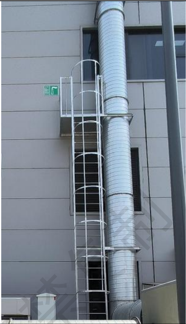
涂胶、灌胶废气处理设施出口监测点及采样平台
